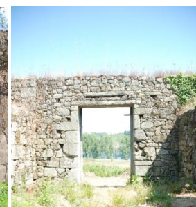
Edifício em ruínas
